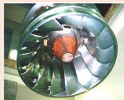
下から見た水車ランナ 旧ランナ：外径1.4m程 新ランナ：外径1.6m程
