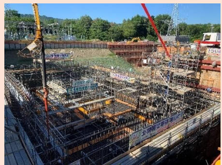
写真①コンクリート打設状況（5回目） 【打設高さ2.60m 延べ11.45m】
