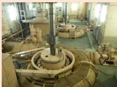
上川発電所の内部：停止した水車 【地下10m程に設置】
