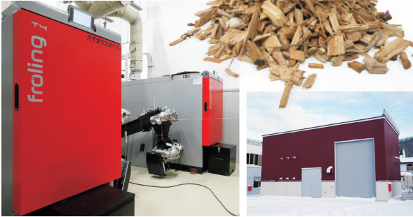
フローリング社製ボイラー(2基) ボイラー棟
