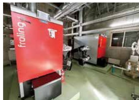
町立診療所の空調管理に使われている バイオマスボイラー
