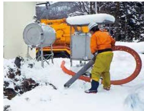
12月、日東の水道施設の灯油タンクから灯油が漏洩し、汚染土の除去を行った。河川や地下水への流出、水道水への影響はなかった。
